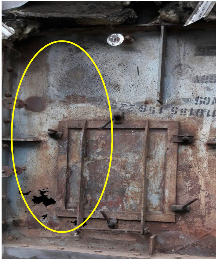
ID FAN CASING: BEFORE
